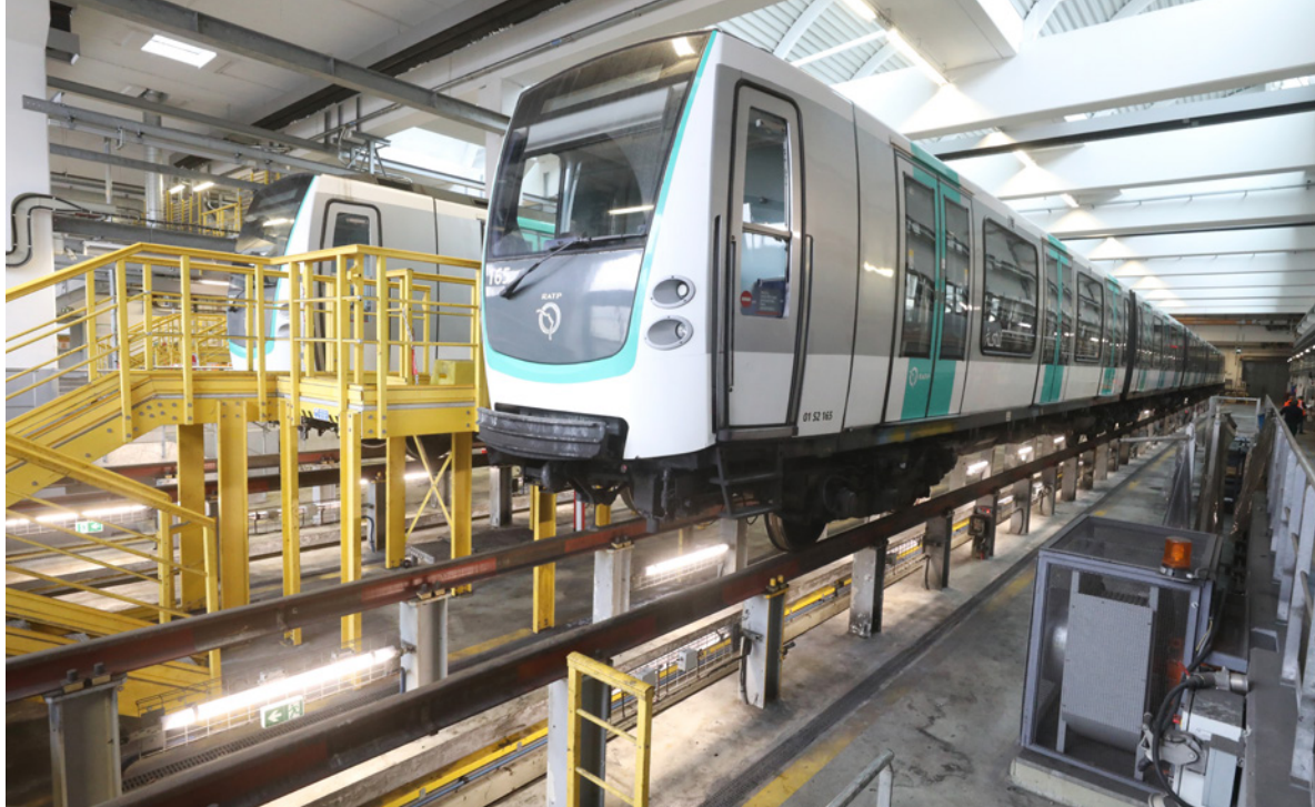
■ L'atelier de maintenance boulonnais où sont révisés et réparés l'ensemble des 74 trains de la ligne 9.
